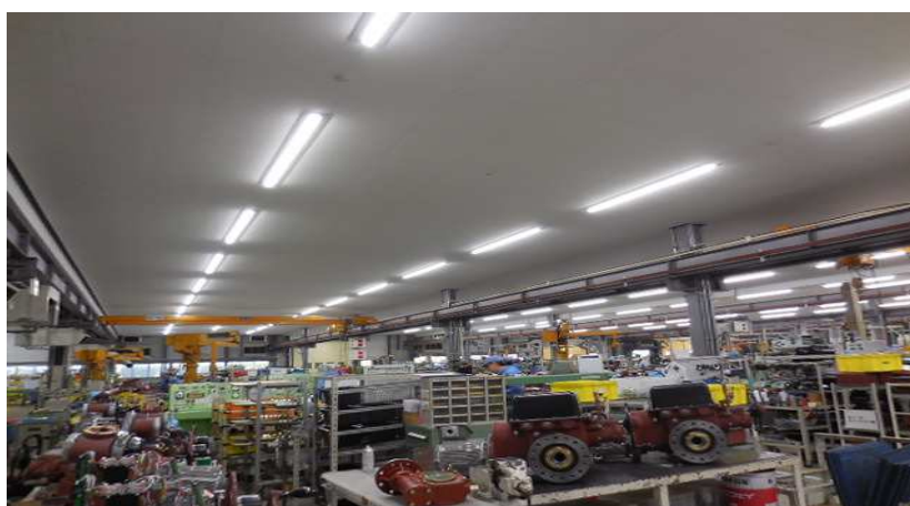
* LED化後の産機工場
